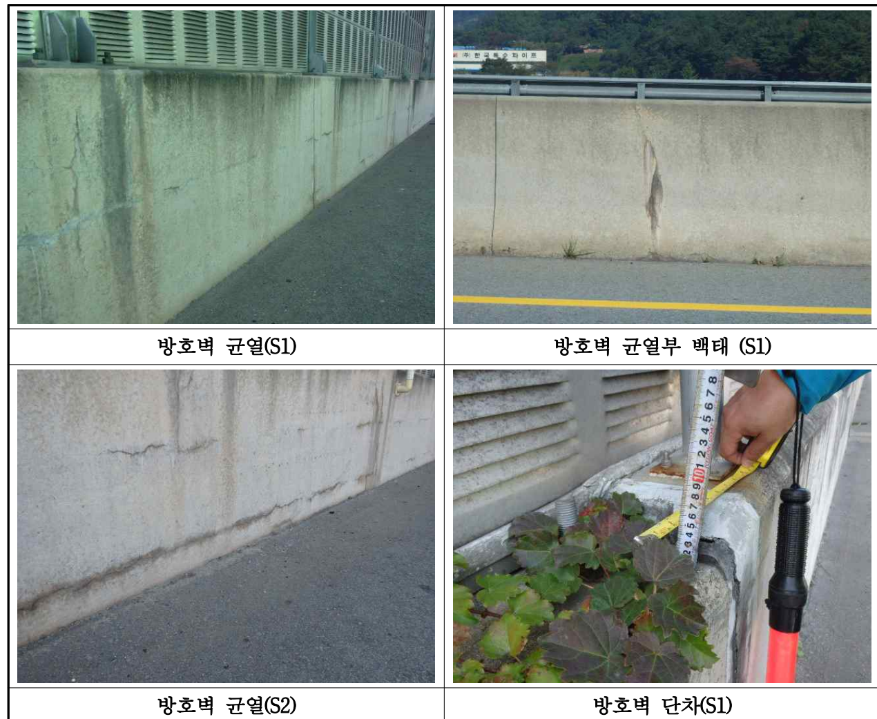
【사진 3.3.19】 방호벽 손상현황(부산)
