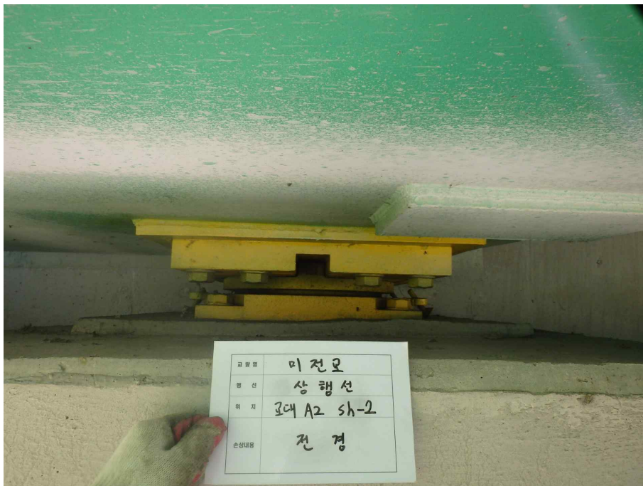
받침장치 전경 (가동단)
