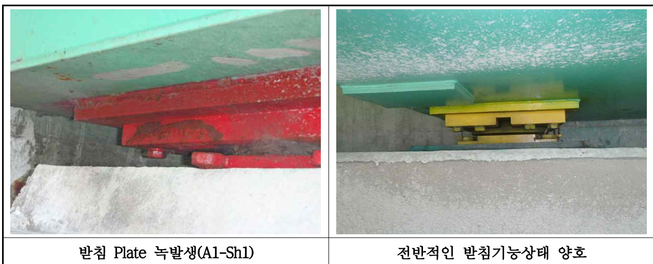
【사진 3.3.11】 교량받침 손상현황(부산)
