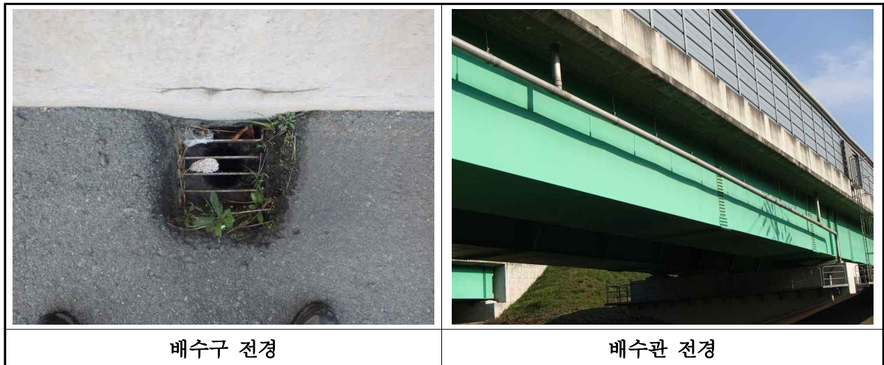
【사진 3.3.17】 배수구 및 배수관 전경(부산)
