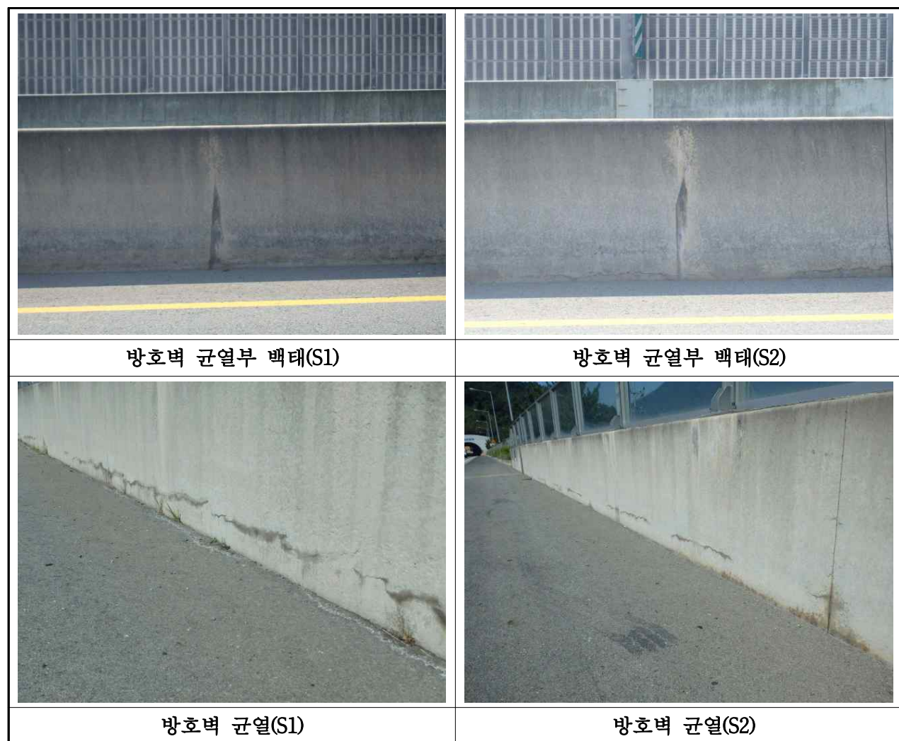
【사진 3.2.18】 방호벽 손상현황(대구)
