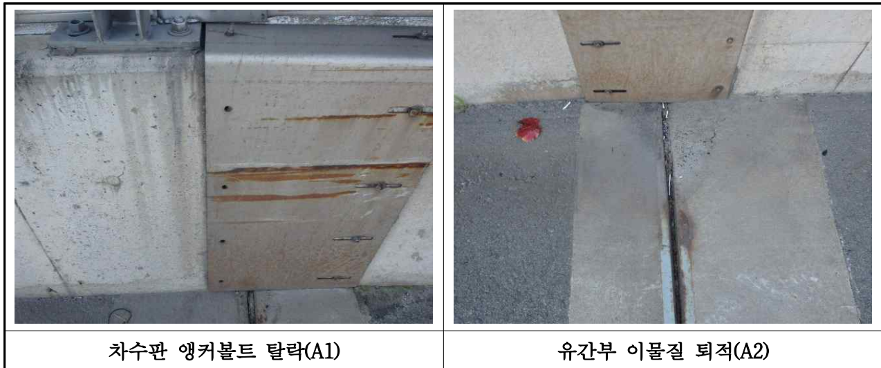
【사진 3.3.13】 신축이음장치 손상현황(부산)
