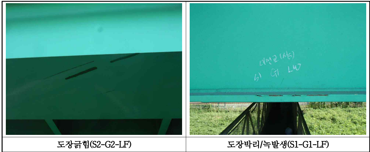
【사진 3.2.5】 강박스 거더 외부 손상현황(대구)
