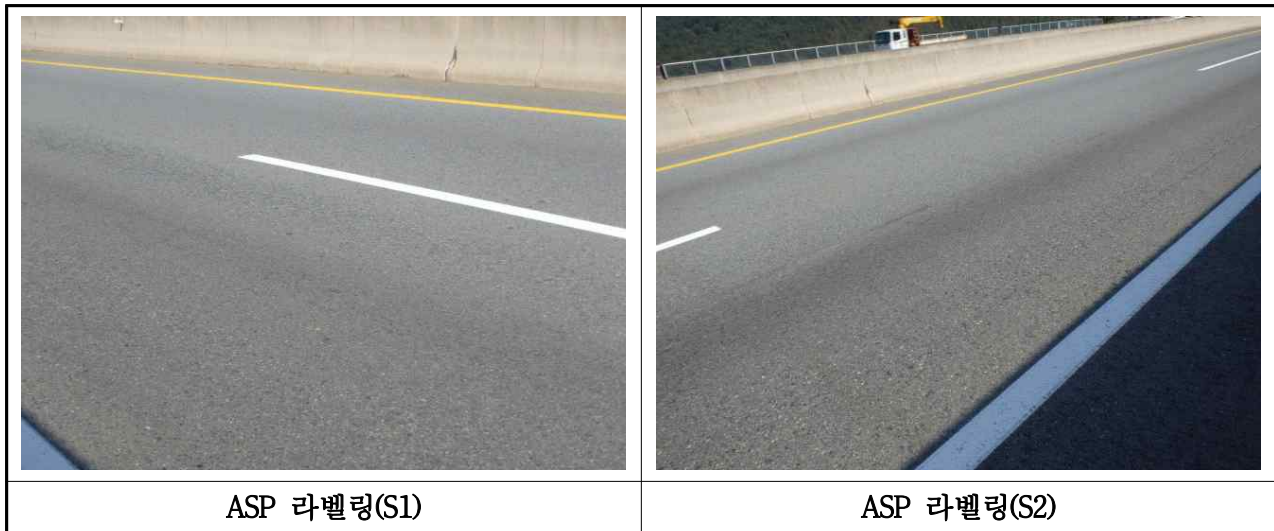
【사진 3.3.16】 교면포장 손상현황(부산)
