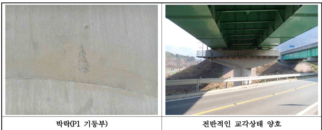
【사진 3.2.9】 교각 손상현황(대구)
